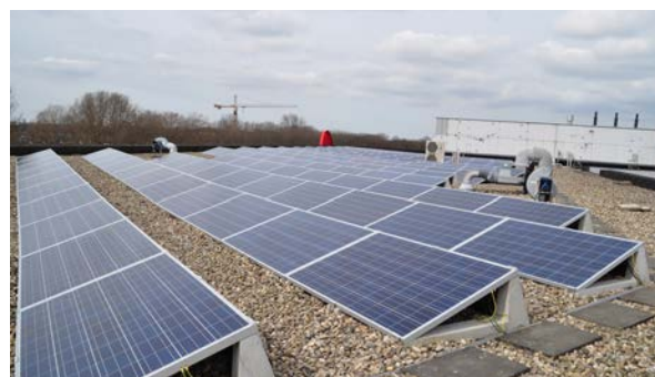
Referentie: energie opwekken op dak
