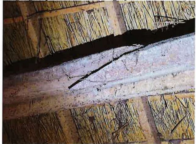
dak no. 3: openstaande verbinding (foto 2021)
