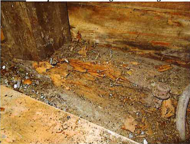
gevel no. 1: ingerotte muurplaat (foto 2021)
