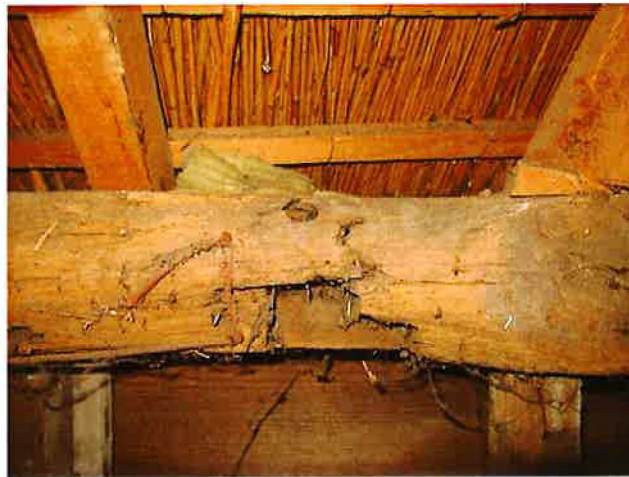
gevel no. 1: gebroken dekbalk (foto 2021)
