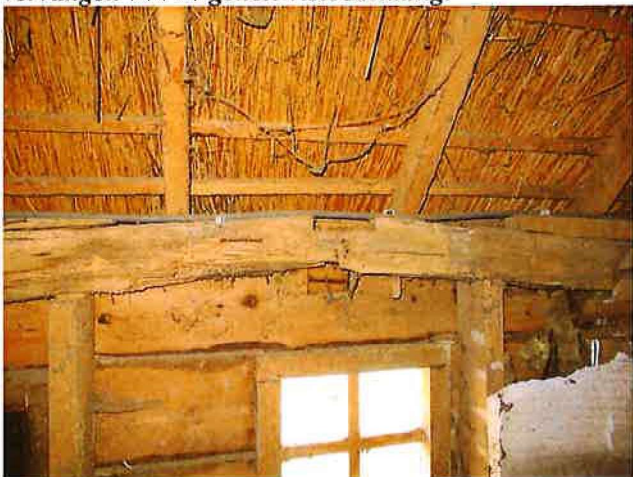
gevel no. 3: verzwakte dekbalk (foto 2021)
