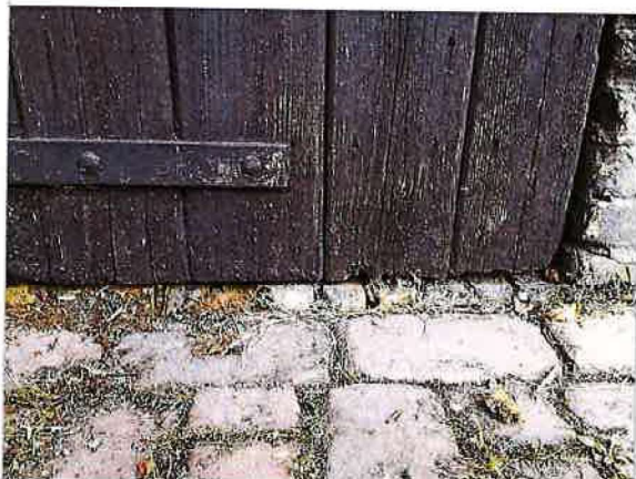
verweerd en ingerot houtwerk buitendeur gevel no. 1 (foto 2020)
