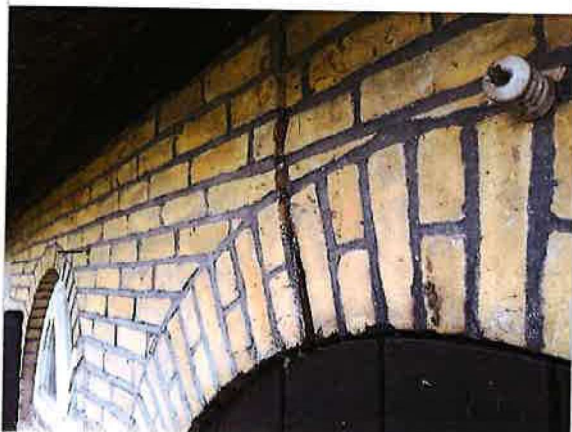
gescheurd en ontzet metselwerk gevel no. 3 (foto 2020)
