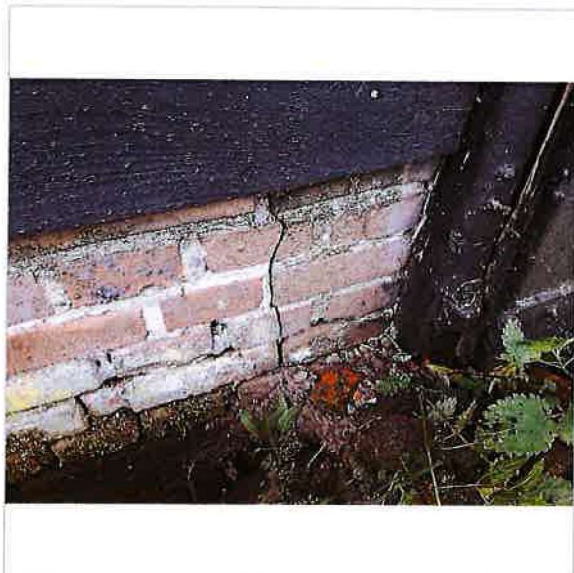
scheurvorming metselwerk gevel no. 3 (foto 2020)
