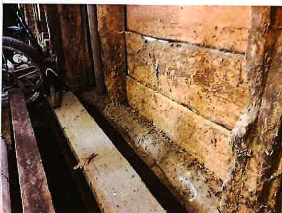
door vee beschadigd houtwerk gevel no. 3 (foto 2020)
