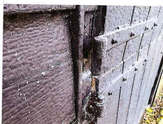
afgebroken en weggevalle duim gevel no. 3 (foto 2020)
