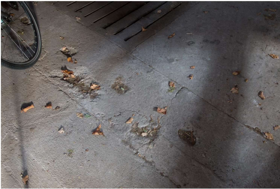
Aftekening van verdwenen stalrepels in de betonvloer.
