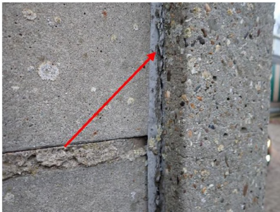
Foto 8 | Foto voor bron Afdichtingskit
