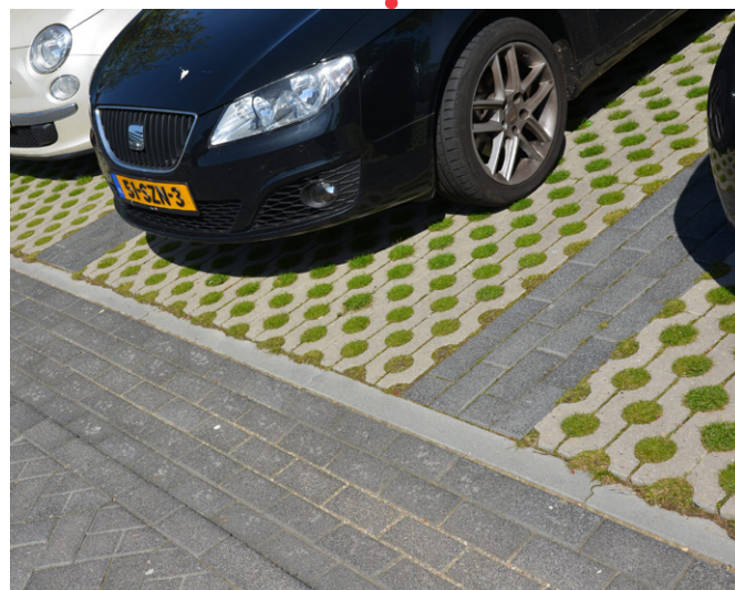
Parkeren op grasbeton met zichtbare markering
