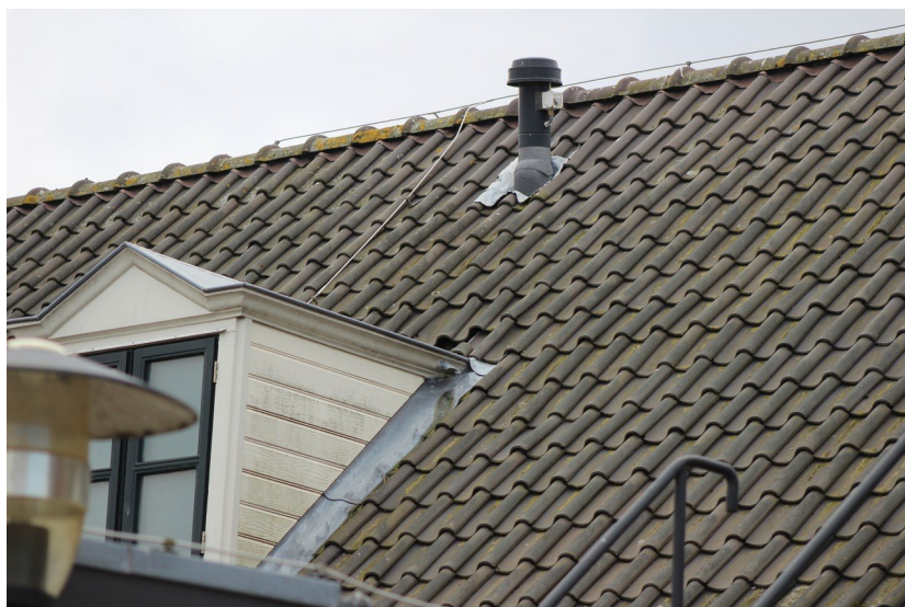
Dakpannen strak en afgewerkt zonder ruimte, behalve boven
