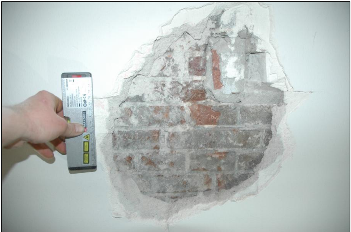
Afb. 19: Muurwerk op de begane grond van I b, westgevel, ingebouwd in de gangaanbouw en gepleisterd. Het voegwerk is 19de-eeuws. We zien een stukje dagkant van een weer dichtgemetseld venster.
