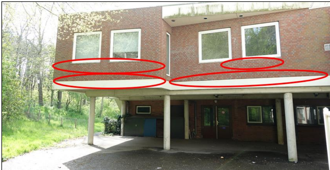
Figuur 7: Open stootvoegen in bebouwing
