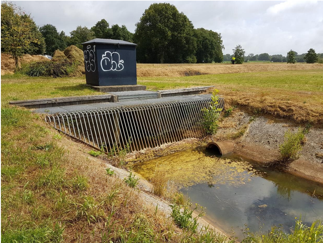
Figuur 2.13 Gemaal voor oostelijk van de Regge gelegen landbouwgebied
