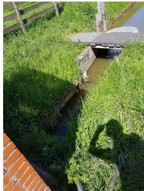
Instroomvoorziening gemaal Het Oude Anker
