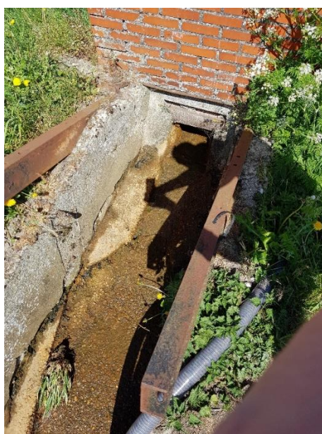
Uitstroom voorziening gemaal Het Oude Anker
