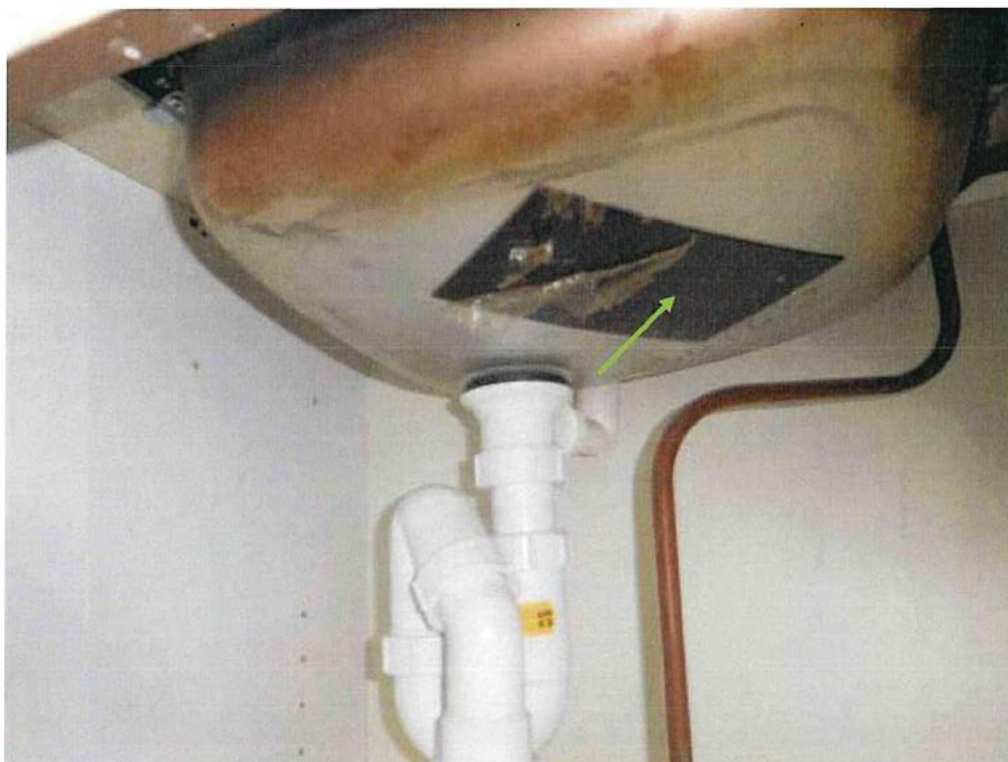
Foto 3 Niet asbesthoudende bitumen plaatje onder gootsteenbak (M03)
