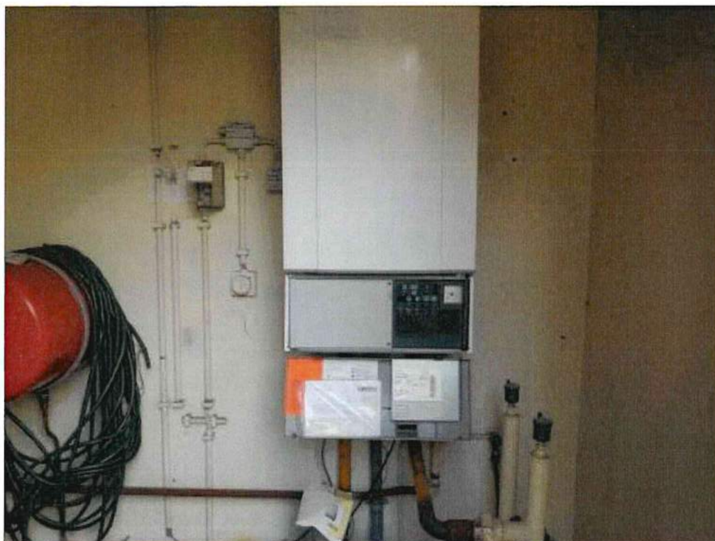
Foto 4 CV ketel, merk Remeha, type Quinta 85 : geen asbest
