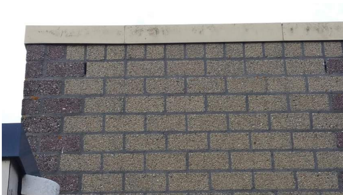
Figuur 4. Muur van het schoolgebouw met open stootvoeg waardoor vleermuizen toegang kunnen krijgen tot de spouwmuur.
