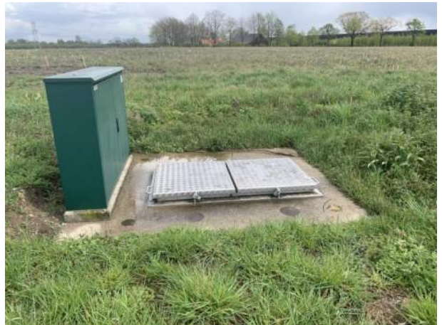
Foto 2 Pompput riolering aan de rand van de onderzoekslocatie
