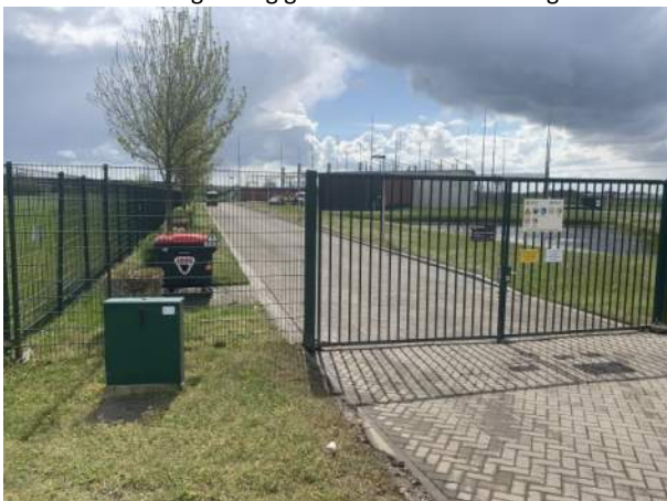
Foto 11 Verdeelstation Enexis gelegen aan de Horsterweg
