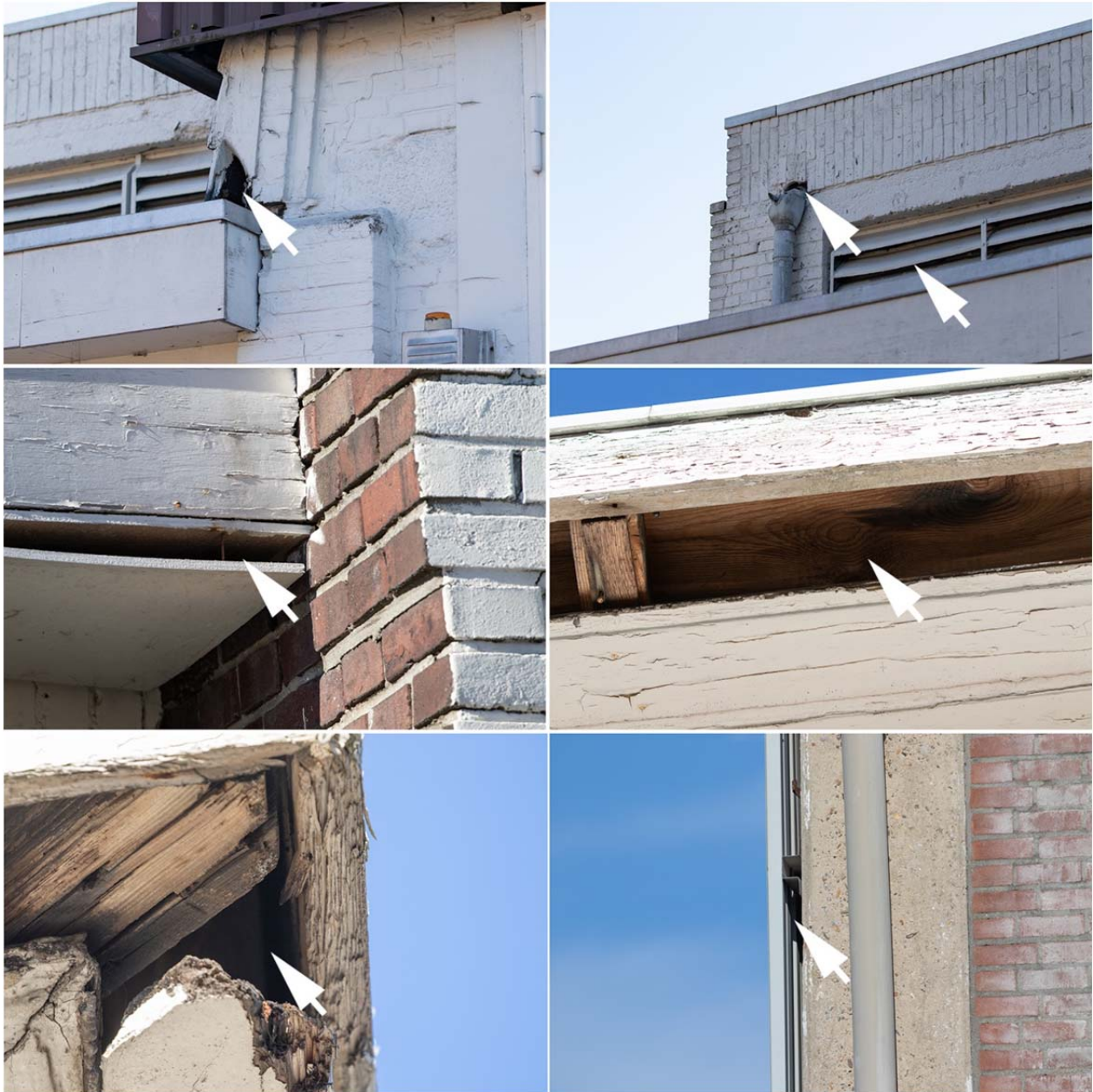
Figuur 4. Het oude supermarktgebouw in verval heeft veel zichtbare gaten en kieren die naar achterliggende verblijfplaatsen voor vleermuizen op ruime valhoogte van de grond kunnen leiden, tevens geschikt als broedplaats voor voor de gierzwaluw en huismussen.
