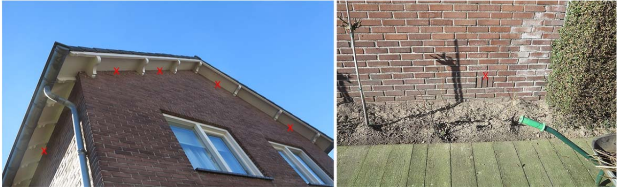
Figuur 3. Huis nr. 49 leent zich met hermetisch afgeslotenheid niet als verblijfplaats voor de gierzwaluw en vleermuizen. Kieren, gaten en nissen naar rust-, nest- of verblijfplaatsen ontbreken; zoals bijvoorbeeld het gebrek aan toegankelijke kieren in de daklijsten en de lage roosters ver beneden de minimale valhoogte voor vleermuizen in de spouwmuren, zoals hier met rode kruizen is aangegeven.
