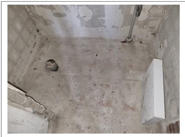
PVC-afvoerbujs in vloer toilet
