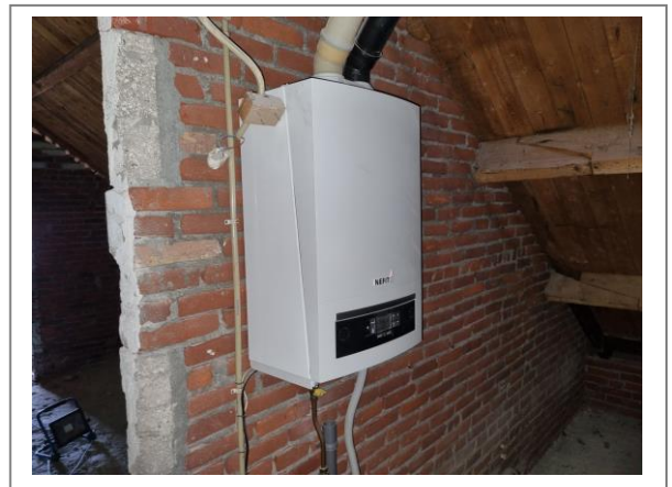
Asbestrijve cv-ketel Nefit
