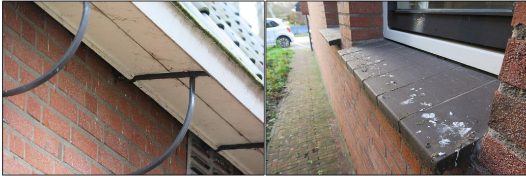
Figuur 3.2 De openingen van de huismusnesten (buiten planlocatie) bevinden zich merendeel onder het overstek. Direct onder het overstek zijn op vensterbank dan ook uitwerpselen van huismus aangetroffen.
