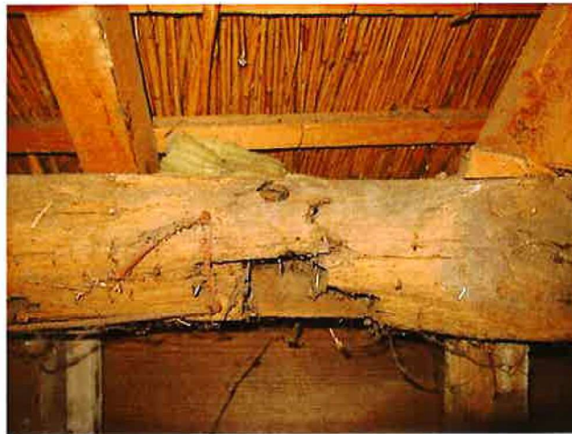
gevel no. 1: gebroken dekbalk (foto 2021)
