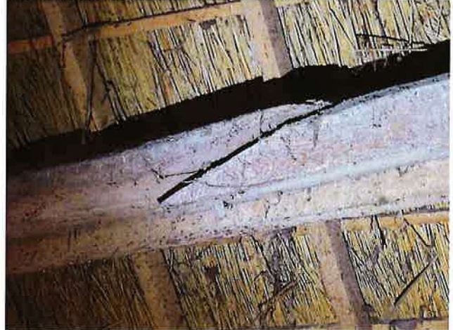
dak no. 3: openstaande verbinding (foto 2021)
