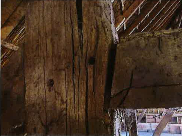
2e gebintstijl onder dak no. 3 vanaf de oostzijde gezien: toognagels vermolmd en gebroken (foto 2021)
