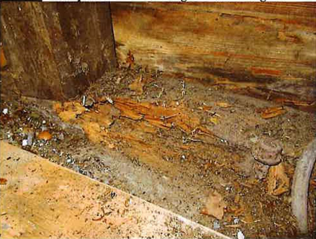
gevel no. 1: ingerotte muurplaat (foto 2021)
