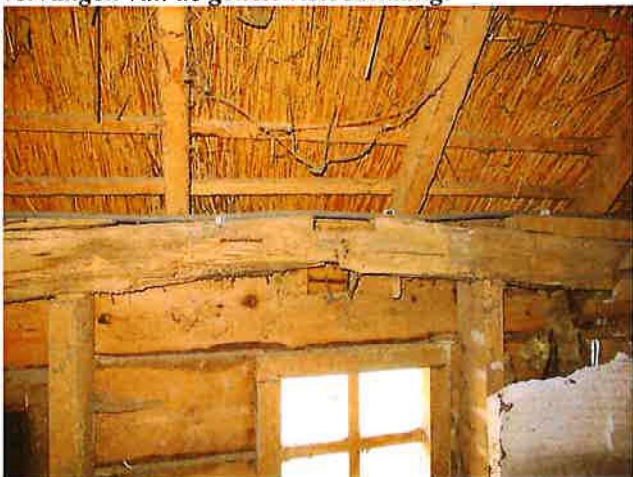
gevel no. 3: verzwakte dekbalk (foto 2021)
