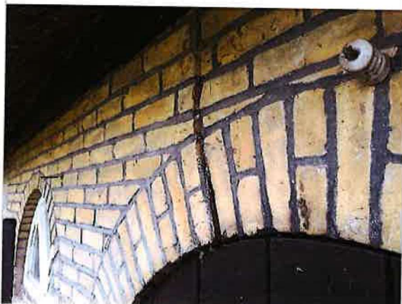
gescheurd en ontzet metselwerk gevel no. 3 (foto 2020)
