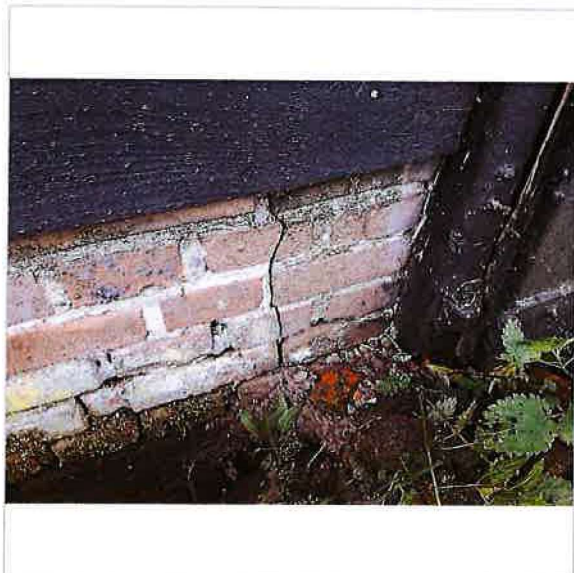
scheurvorming metselwerk gevel no. 3 (foto 2020)
