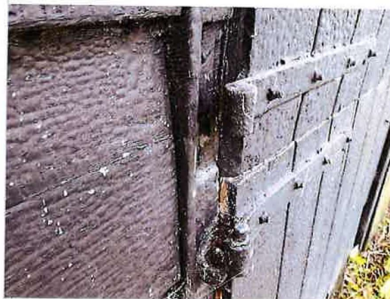
afgebroken en weggevallen duim gevel no. 3 (foto 2020)
