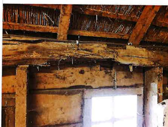
aangetast houtwerk door eerder inrotting gevel no. 3 (foto 2020)
