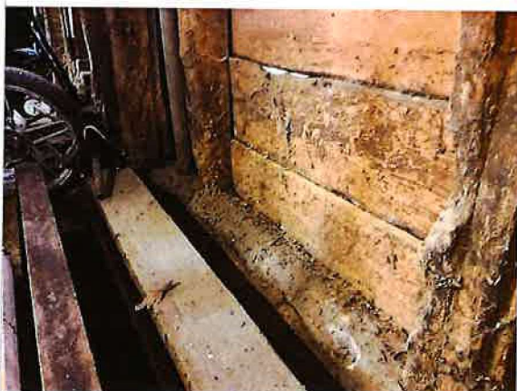
door vee beschadigd houtwerk gevel no. 3 (foto 2020)
