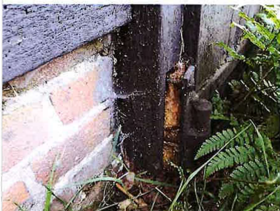
ingerot houtwerk stijl gevel no. 3 (foto 2020)
