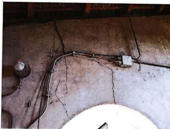
gescheurd en ontzet metselwerk buitenmuur gevel no. 1 (foto 2020)
