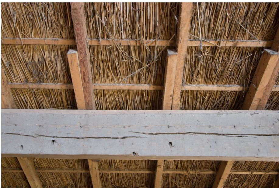
Ook in de gebintplaten toognagels voor verdwenen daksporen aanwezig. De huidige sporen zijn van vurenhout en zullen uit de tweede helft van de twintigste eeuw dateren. Vermoedelijk zijn ze aangebracht bij de laatste vernieuwing van het rieten dak.
