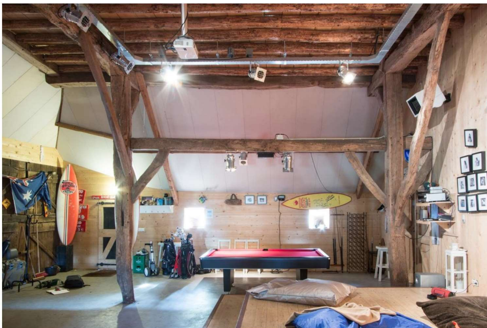
Eerste en tweede gebint gezien in de richting van de linkerkant van de schuur. Steekrij met windverbanden in verband met het overstek in de linker zijbeuk.
