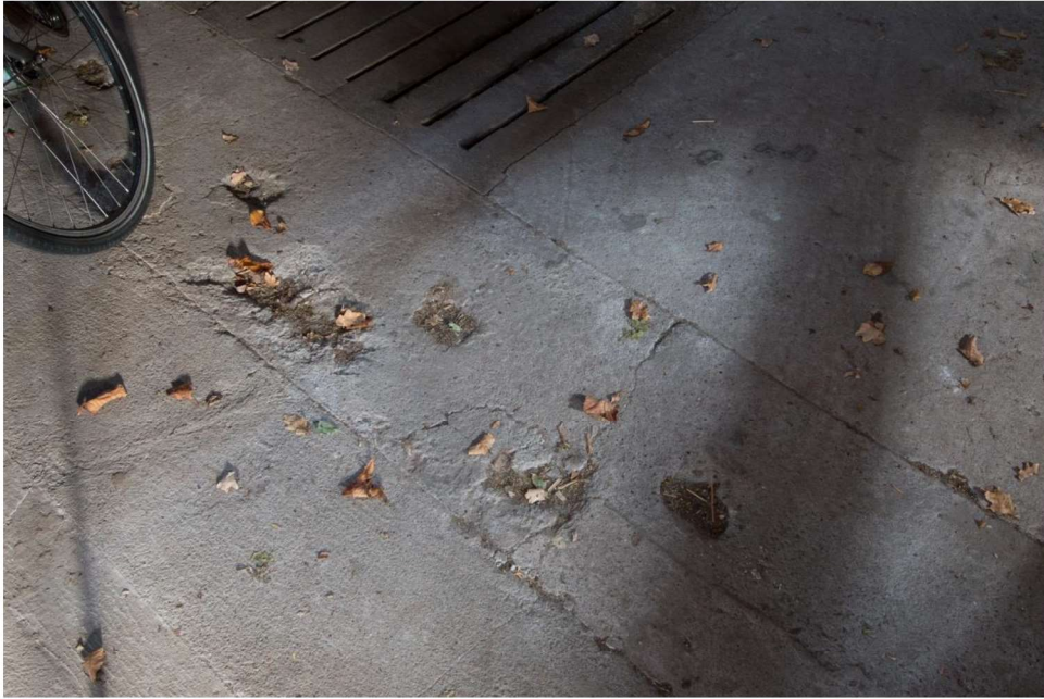
Aftekening van verdwenen stalrepels in de betonvloer.
