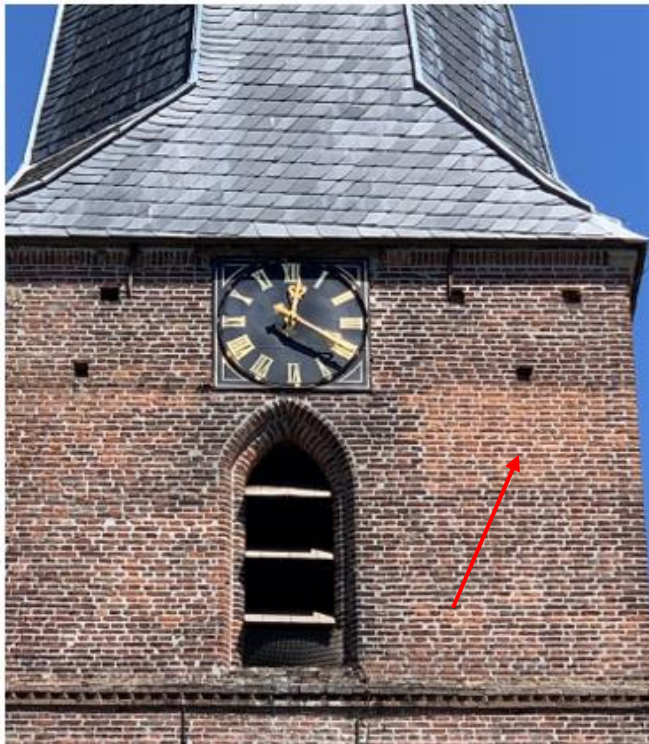
Figuur 14: Zichtbaar herstelde schade granaatinslag (rode pijl)
