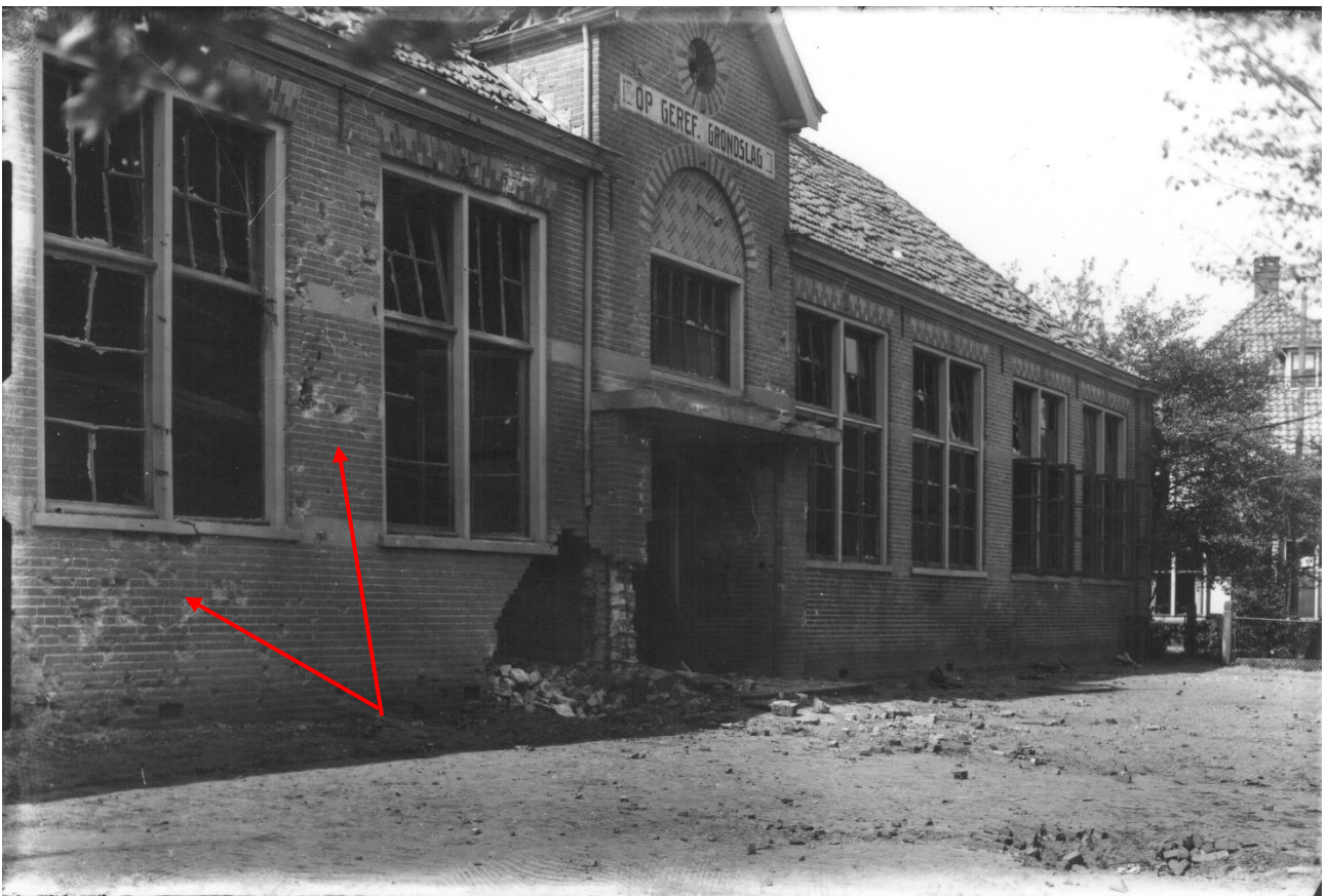
Figuur 12: Schade aan Hervormde school. Duidelijk scherfinslagen op de muren (rode pijl)
