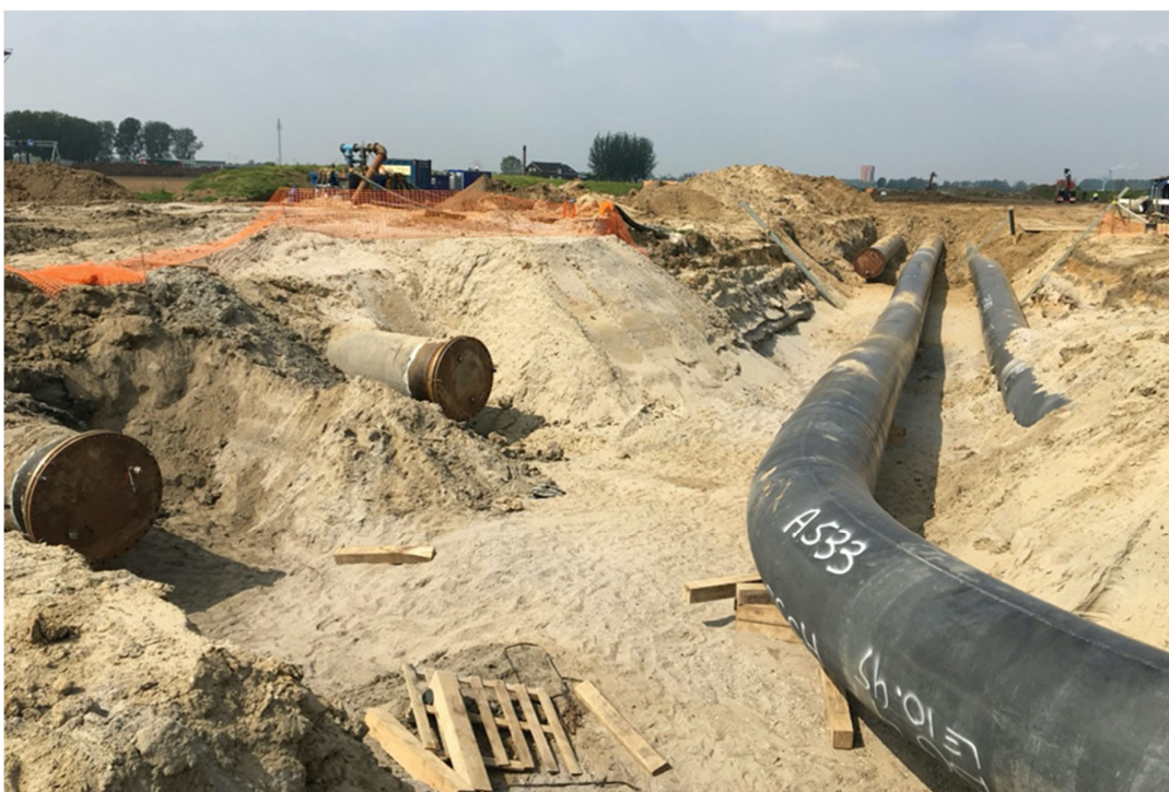
Afbeelding 5. TIE-IN put Zuid (eigen foto).
