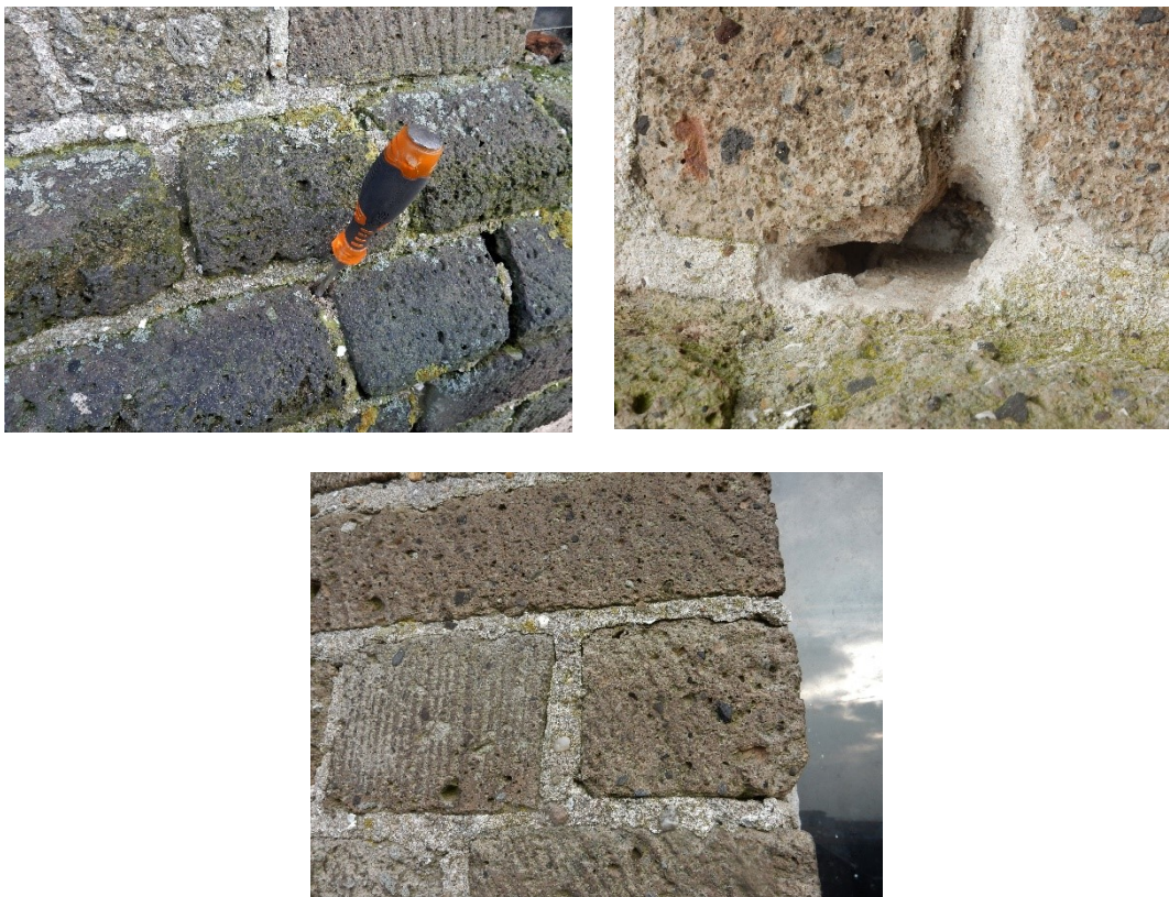
Figuur 3: Boven, geen samenhang in de legmortel achter de voeg. Onder, geen hechting tussen voeg en tufsteen
