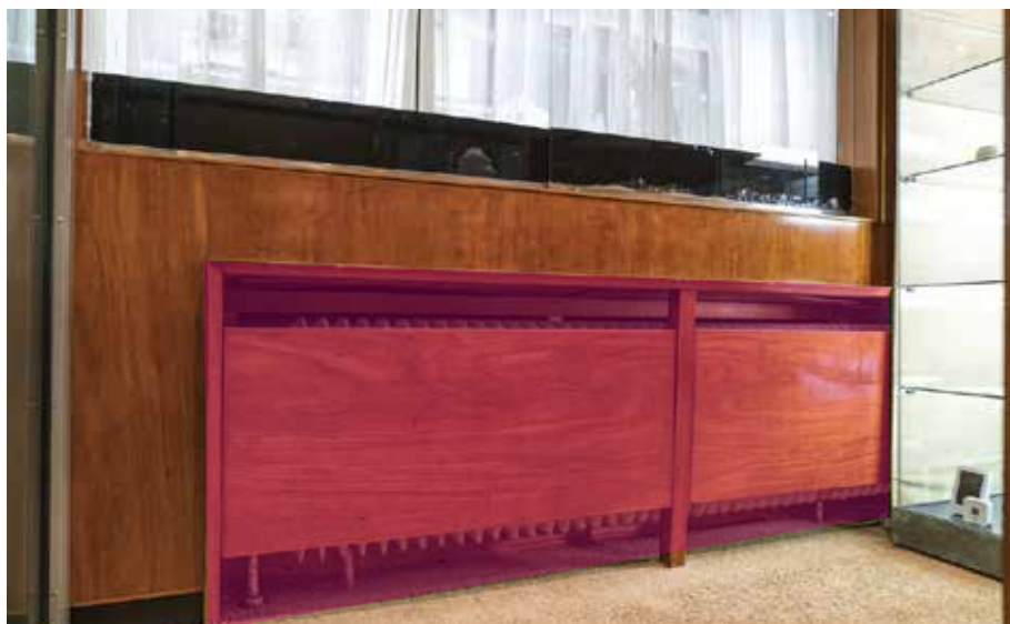
radiatoren ter plaatse meanderende gevel
