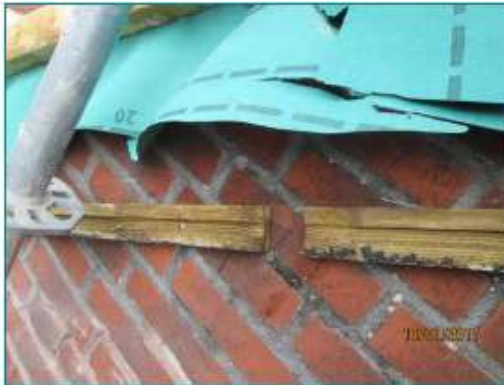
Figuur 4: Muurlatten voor bevestiging trespa boeibord met opening voor toegang vleermuizen achter boeibord. Folie wordt weggesneden.
