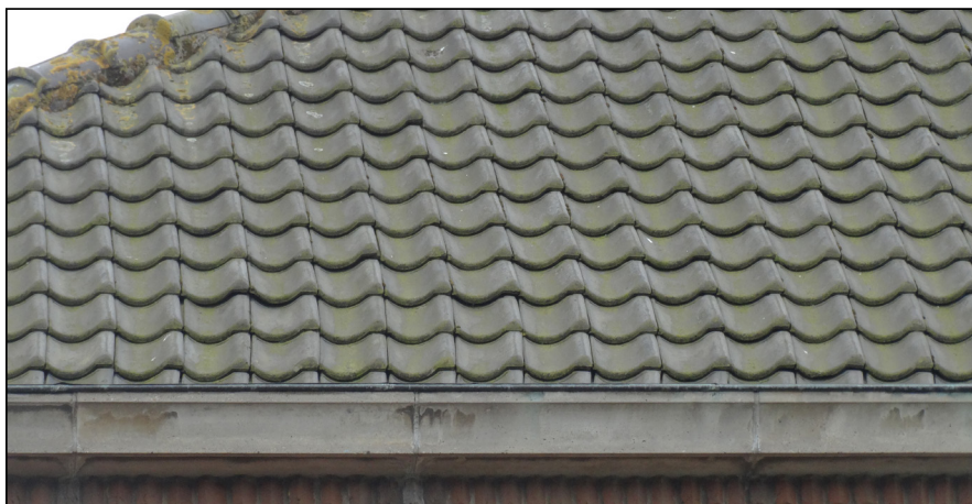
Figuur: de dakpannen op de kerk zijn ongeschikt voor huismussen aangezien er geen ruimte is om tussen te kruipen.
