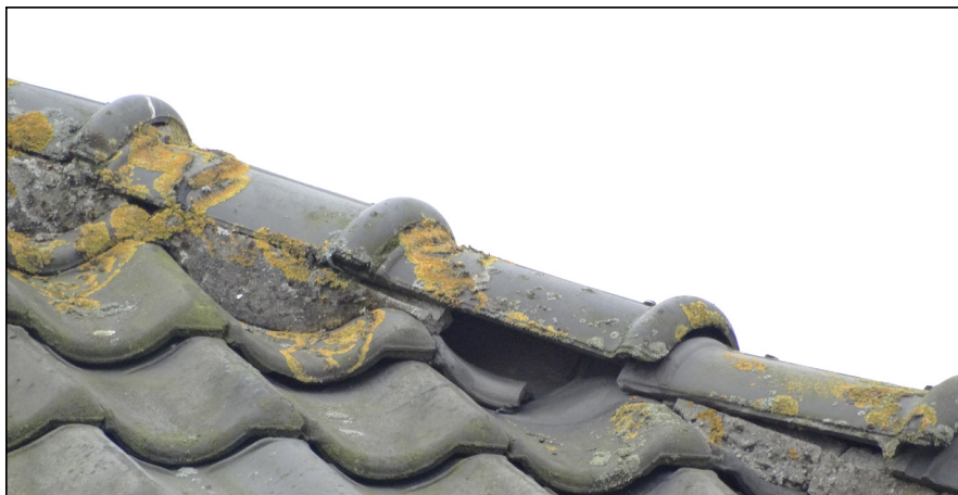
Figuur: op sommige plekken op het dak zijn er ruimtes ontstaan (gaten of kapotte dakpannen) waar vleermuizen en spreeuwen tussen kunnen kruipen. De rest van de nokpannen is dicht gesmeerd.
