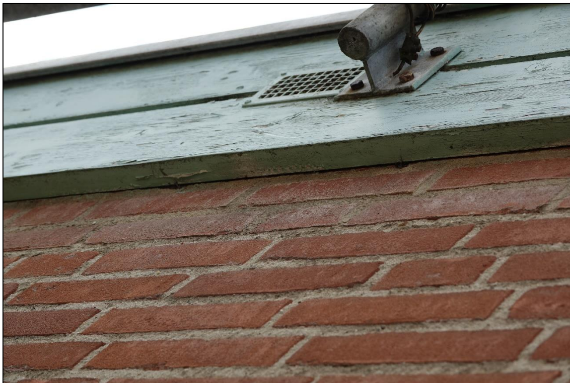
Figuur 7: Gevelbetimmering aan de Kerkstraat welke goed aansluit op de bakstenen en geen ruimte biedt.
