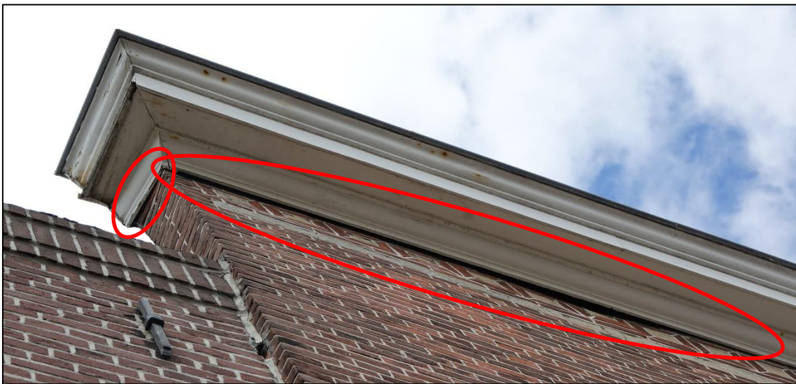
Figuur 9: Houten dakafwerking welke niet goed sluit op de gevel en daarmee ruimte biedt voor vleermuizen.
