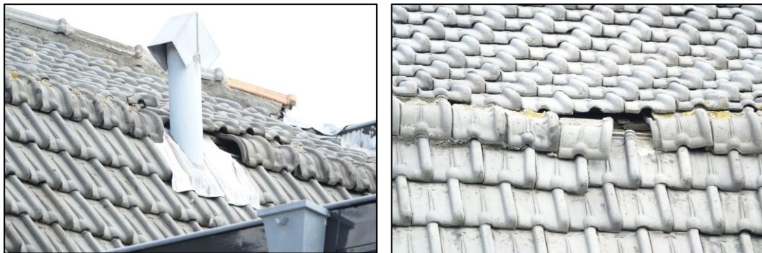
Figuur 11: Missende en kierende dakpannen.
