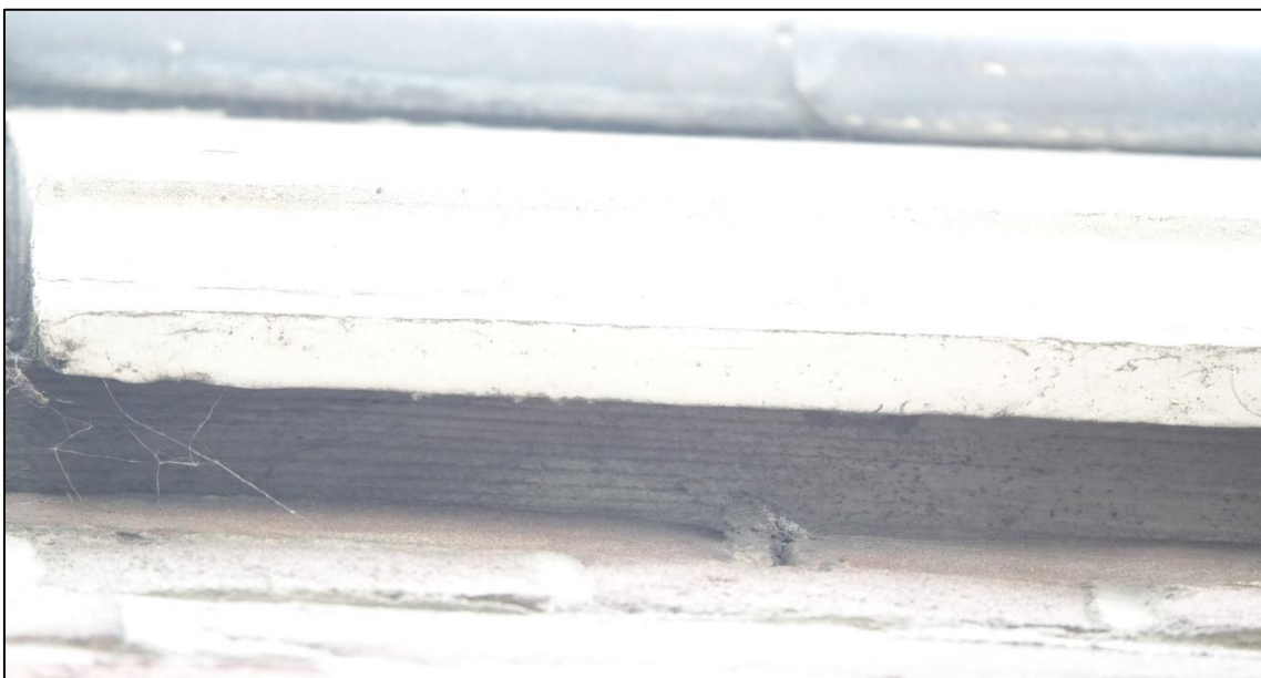
Figuur 10: Gevelafwerking aan de zijkant van de Achterweg welke geen ruimte biedt voor vleermuizen door een latje achter het houtwerk.
