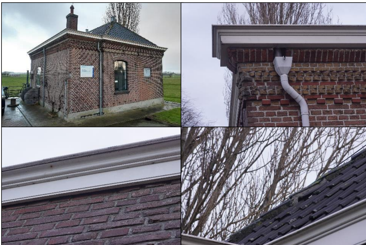
Afbeelding 2: Gemaalgebouw (linksboven), ruimte tussen gevel en regenpijp (rechtsboven), ruimte tussen daklijst en gevel (linksonder) en losliggende dakpannen (rechtsonder).
