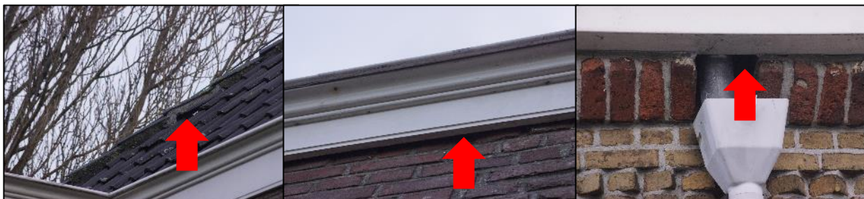
Afbeelding 6: Ruimte tussen losliggende dakpannen (links), ruimte tussen daklijst en gevel (midden) en ruimte tussen regenpijp en gevel (rechts).
