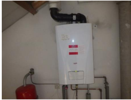
voorbeeld asbestvrije cv ketel / Foto 10
