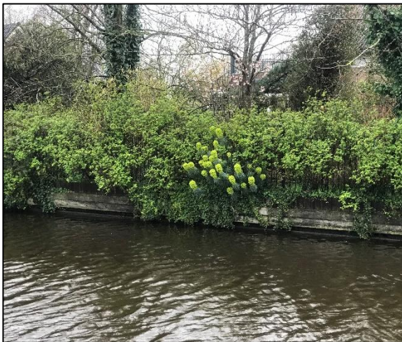
Afbeelding 1.5 | Zuidkade Kollensloot, gezien vanaf weg Woerdense Verlaat
