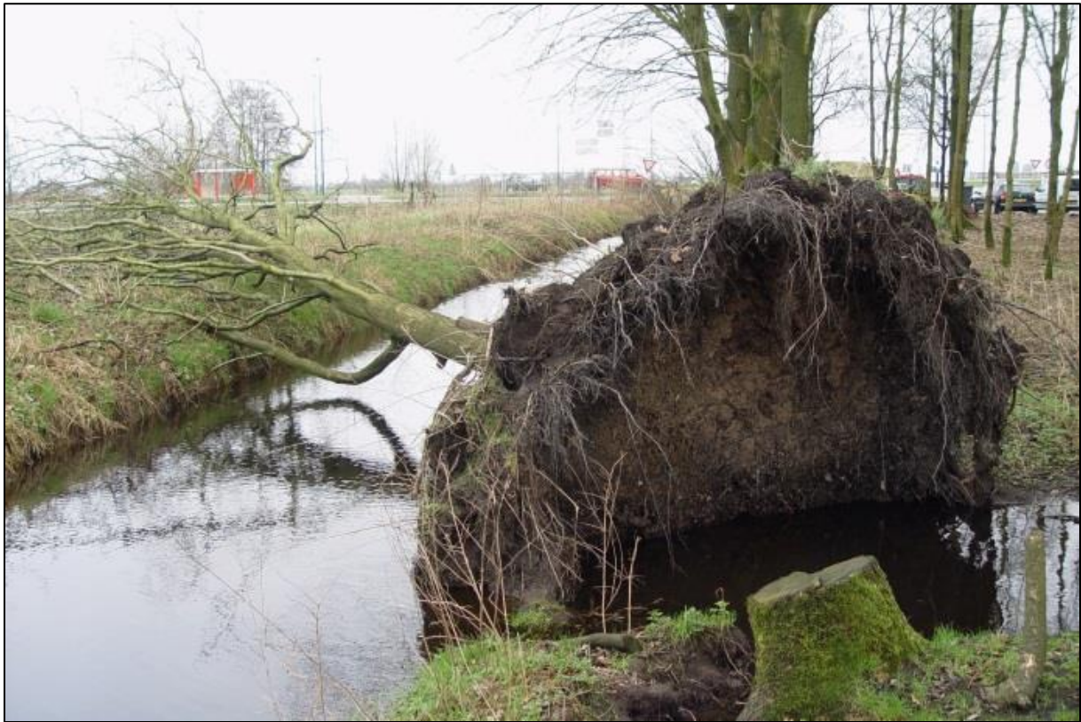
Figuur 2 Voorbeeld van een ontgrondingskuil die een gat in de dijk heeft veroorzaakt (Bron: Bomenwacht, 2019).
