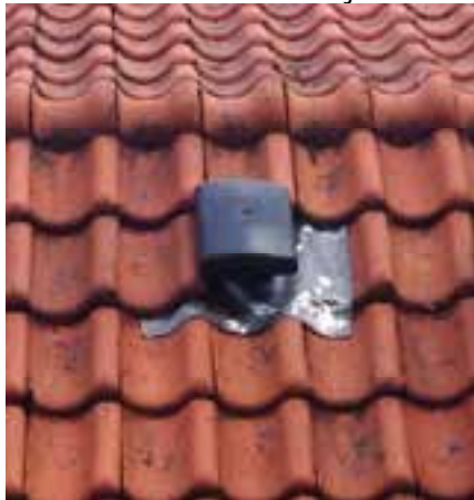
Buitenaanzicht ventilatiekap dakpan
