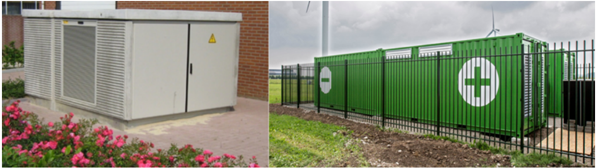
Afbeelding 3.5 Impressies trafo (links) en accu (rechts) (bron: Emission Projects)
