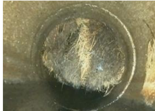
wortels in het riool
