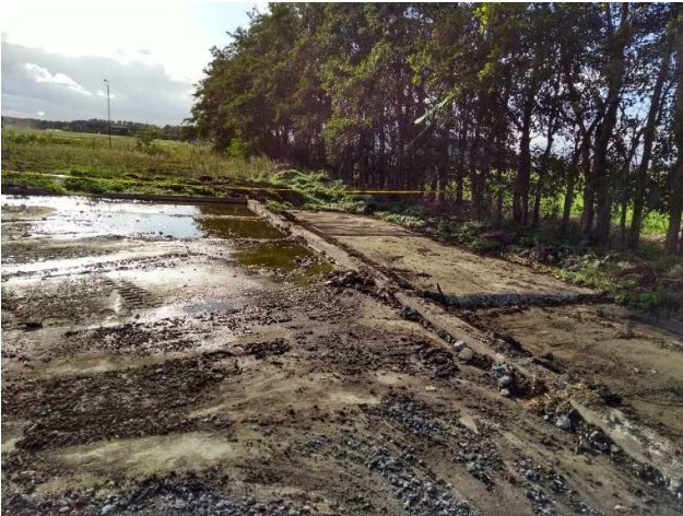
Foto 61: Algemeen tijdens NO asbest 2
