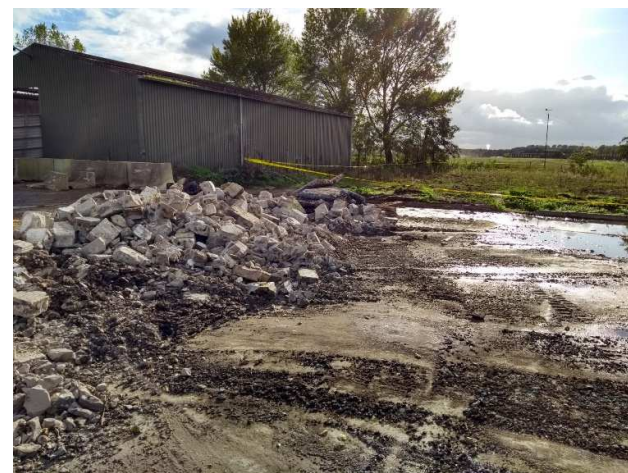
Foto 60: Algemeen tijdens NO asbest 1
