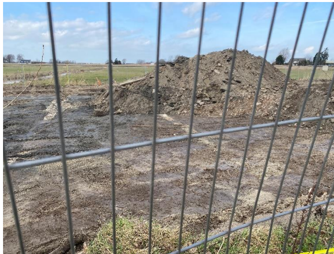
Foto 17: Depot asbest en puin
