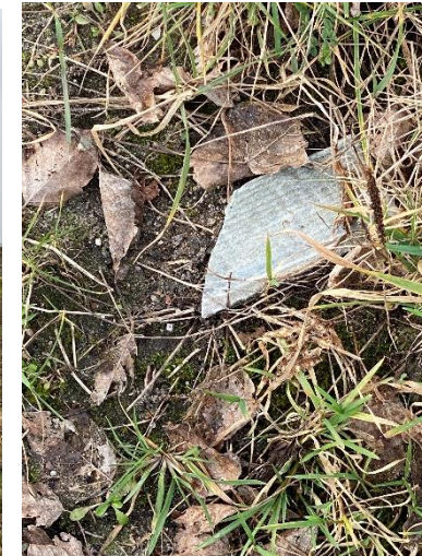
Foto 9: Asbest op maaiveld (2)
