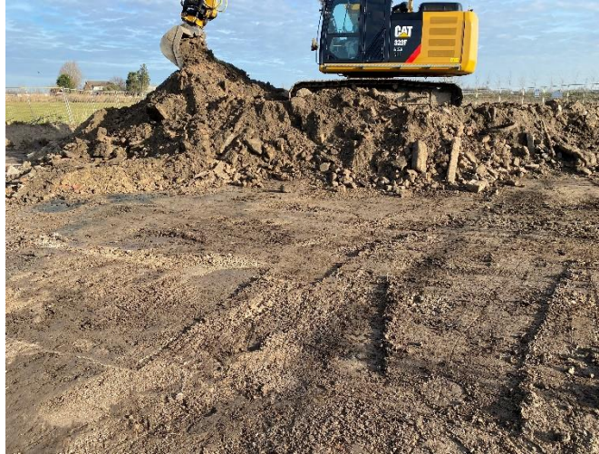
Foto 20: Depotvorming puin en asbest
