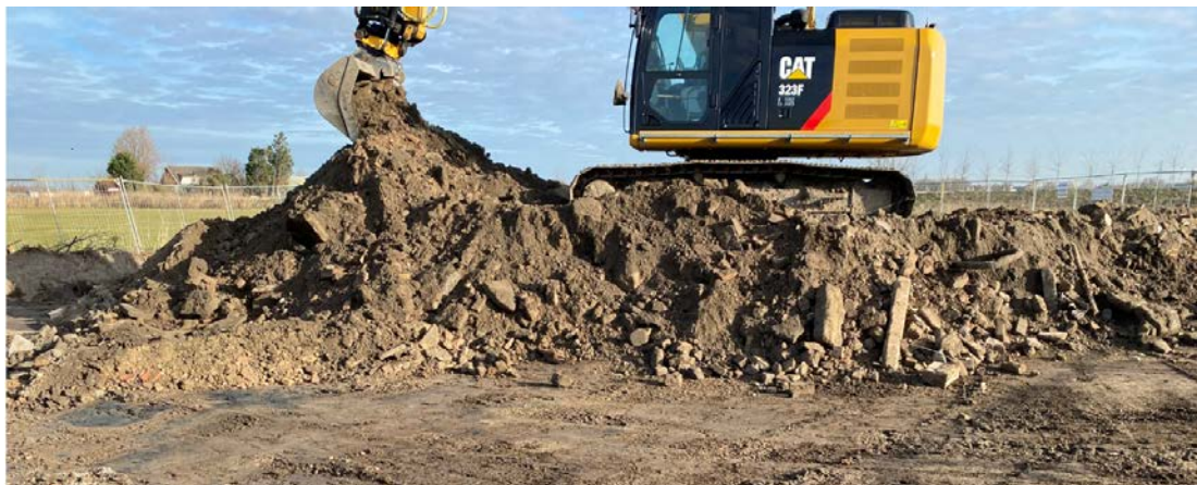
Figuur 4.1: Depotvorming asbest verontreiniging
