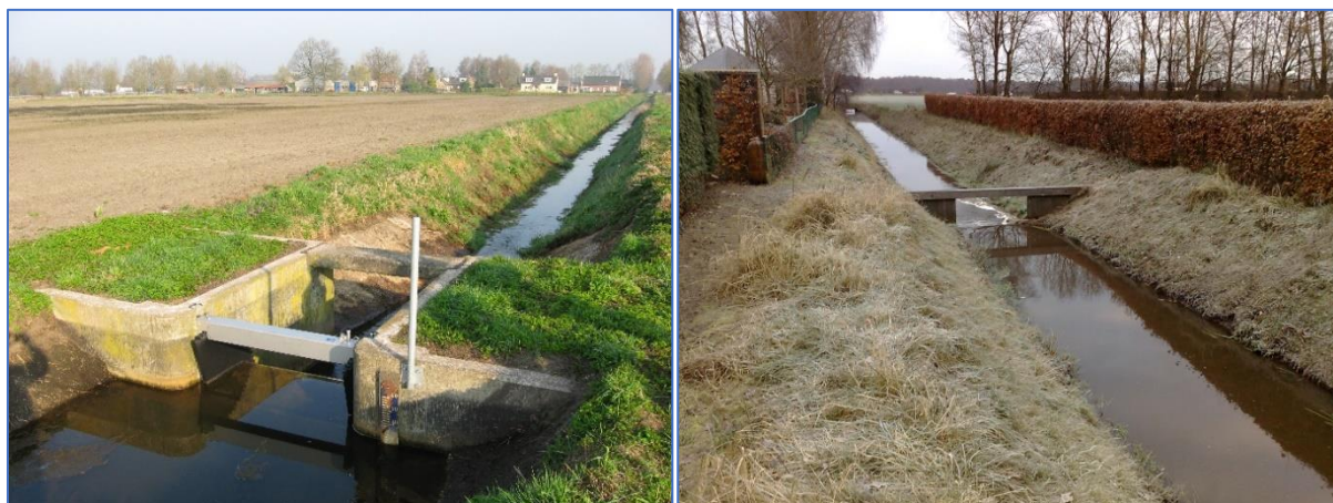
Links stuw 104FIV en rechts stuw 104FMV (foto is uit 2010 waarbij de stuw nog niet is verdrongen)
