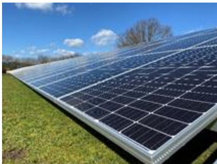
Zonnepanelen op rioolwaterzuivering Haaksbergen
