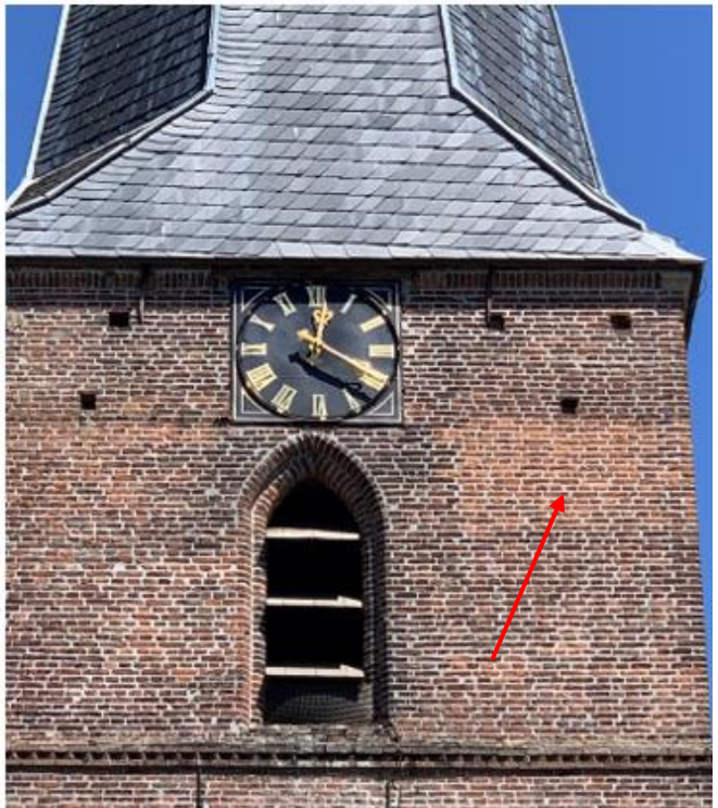
Figuur 14: Zichtbaar herstelde schade granaatinslag (rode pijl)
