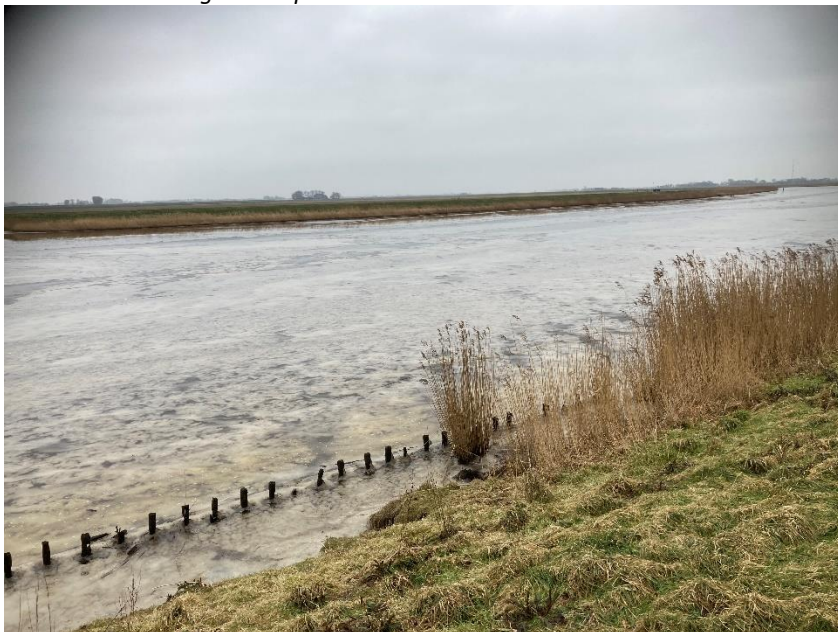
Slechte staat van bestaande beschoeiing Reitdiep, ontbreken rietkraag
