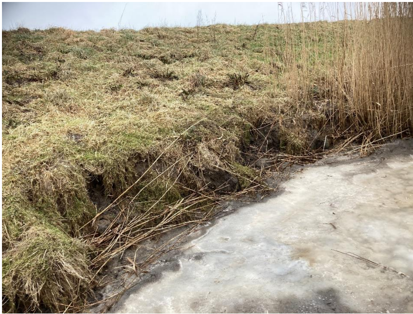
Schadebeeld kering Reitdiep
