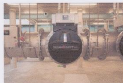
Waterzuivering met behulp van ultraviolet licht. Het is slechts een van de vele stappen om van bron- of oppervlaktewater verantwoord drinkwater te maken.
