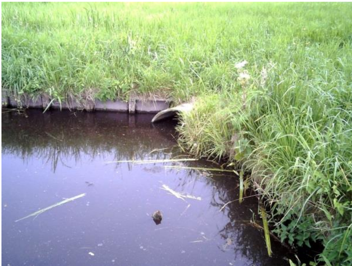
Figuur 2c: Foto huidige inlaatduiker op beoogde locatie toekomstige open verbinding door de Baarsjeskade en aan te leggen fietsbrug
