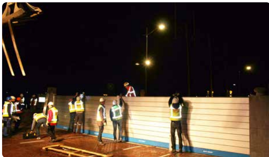
Proefsluiting schotbalkenkering Kampen
