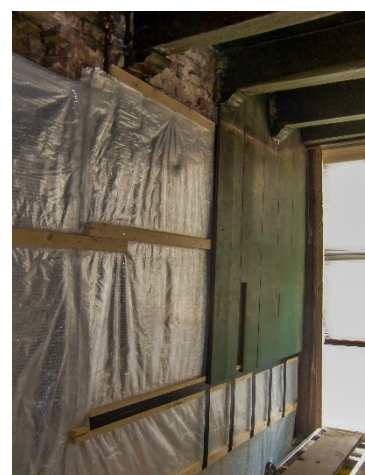
Isoleren rijksmonument Sneek
