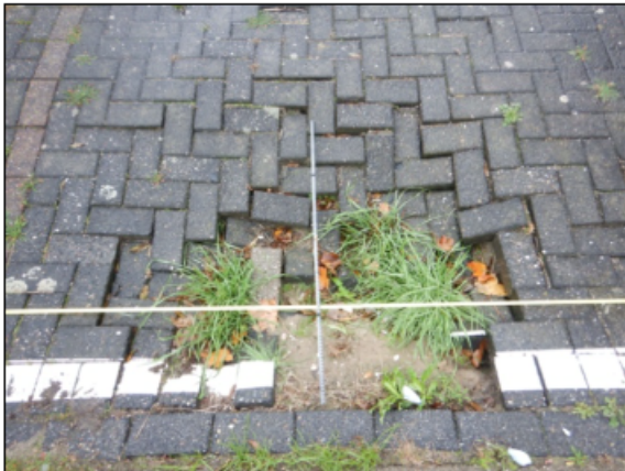
Foto 14: Sinkhole op ca. 15 m
