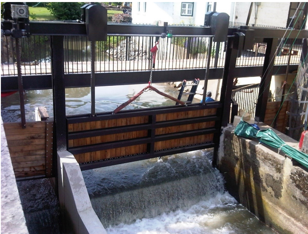
Afbeelding: maalsluis (rechts) en lossluizen (midden en links) stuw molen Lombok
