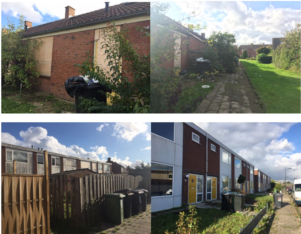
Figuur 3.1 impressie fase 1a met type woningen Frank v. Borselenstraat boven en Jacoba v. Beierenstraat beneden. Op de foto's is te zien dat al een fors deel van de woningen niet meer bewoond (en dichtgespijkerd is i.v.m. vandalisme).
