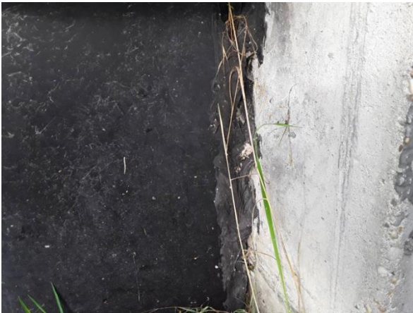
FB02: De flexibele kit tussen de betonconstructie en het nieuwe gedeelte is gezien het bouwjaar (2016) niet asbestverdacht.
