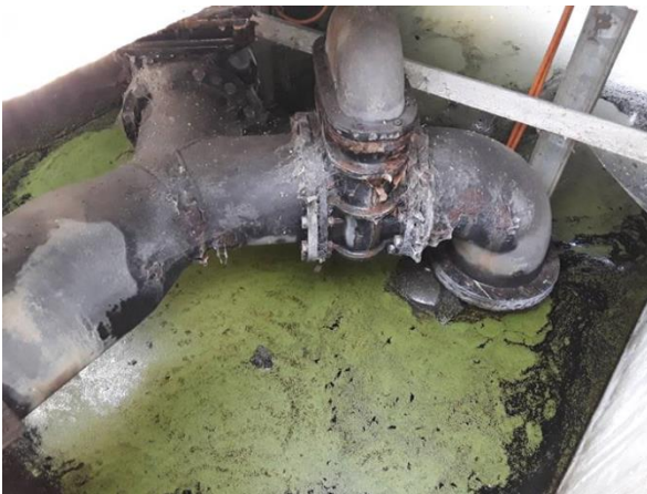
FB03: Uitsluitingen, Arij Koplaan 3 Kelder, installatie
