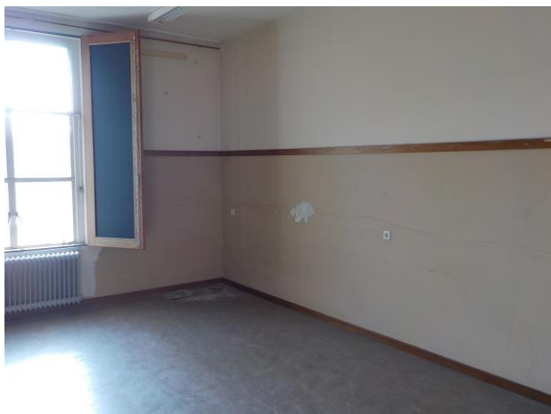
Vleugel A: bitumen lijmlaag in de lokalen links van de gang
