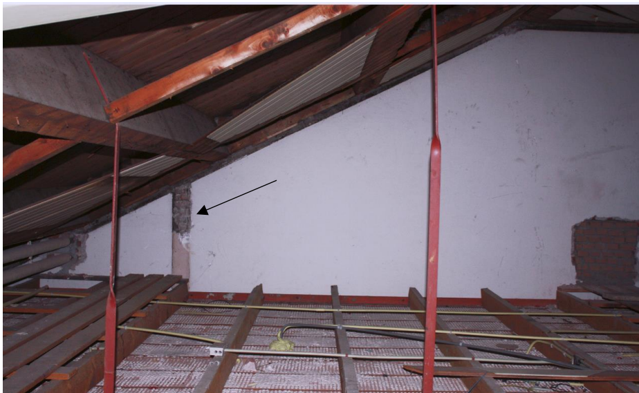
De afdruk van de originele gangmuur tegen de zijgevel op de verdieping bij de achtervleugels is nog zichtbaar in het pleisterwerk van de scheidingsmuren.
