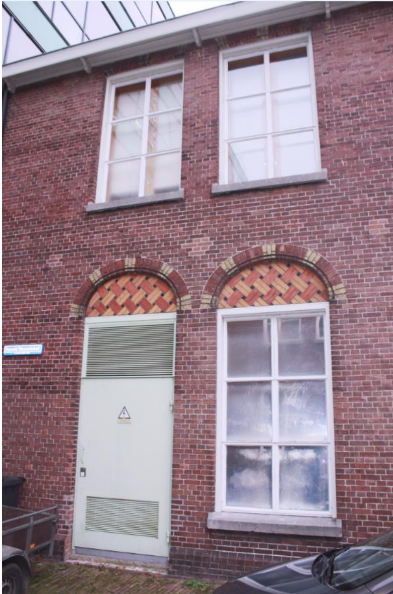
De kozijnen in de achtervleugels zijn later aangebracht. Ook de 6-ruits ramen zijn van een latere bouwphase, vermoedelijk omstreeks 1960.
