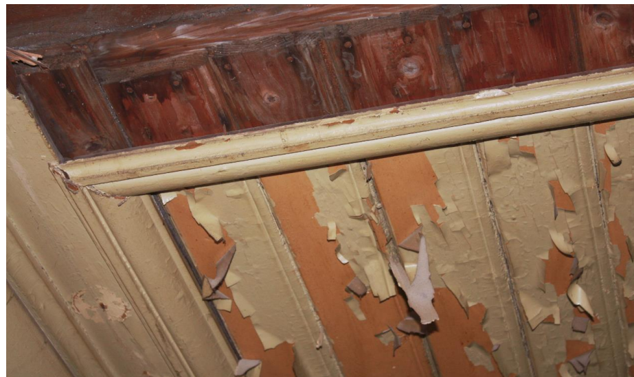
De oorspronkelijke okergele kleurafwerking van de betimmering boven de verdiepingen van de achtervleugels is zichtbaar onder de afbladerende crèmekleur.
