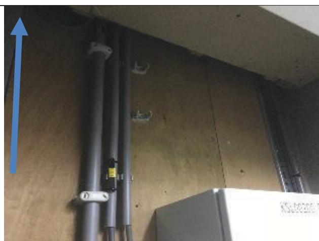
Door bestaande goot
